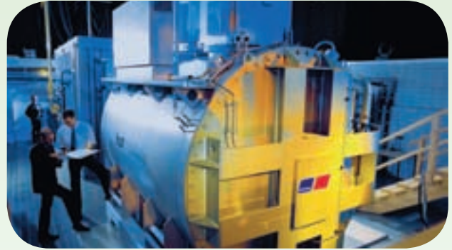
MTU bränslecell installerad i Tyskland på sjukhuset Rhön-Klinikum. Bränslecellen har effekten 250 kW e l och 180 kW v ärme och den har varit i drift mer än 21 000 timmar.
