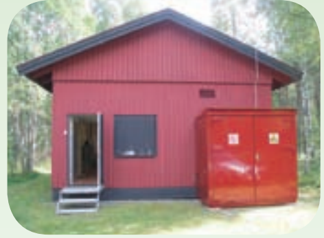
TeliaSonera har installerat en bränslecell från Cellkraft som reservkraftsaggregat i en telestation i Jönköping.
